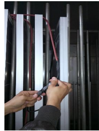
Figura 3. Conexión de los módulos a la fuente de corriente.
